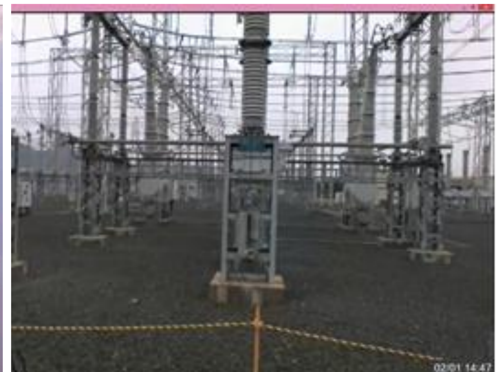
変電所での映像例
