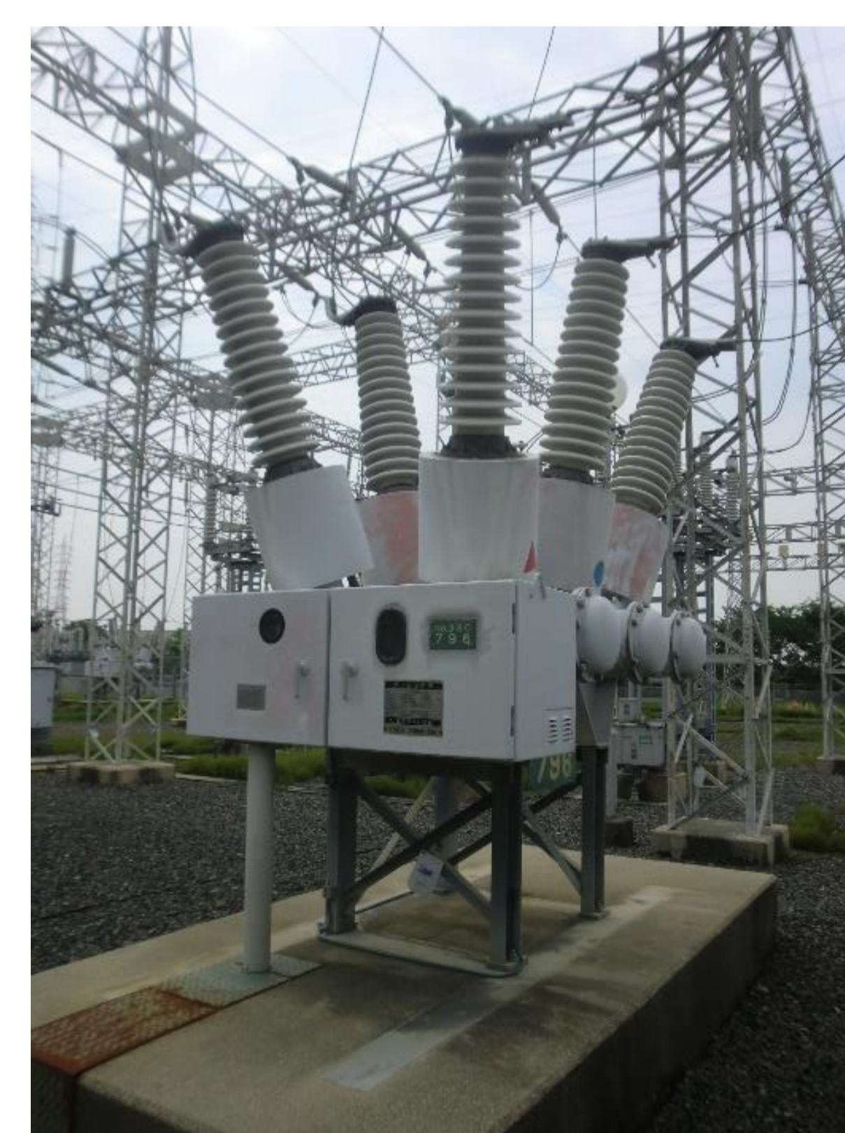
77kV遮断器の例
