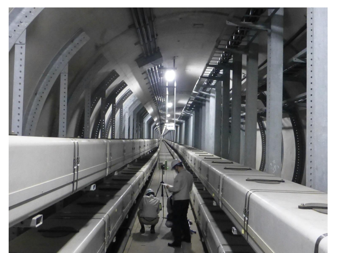
洞道内 通信実験
