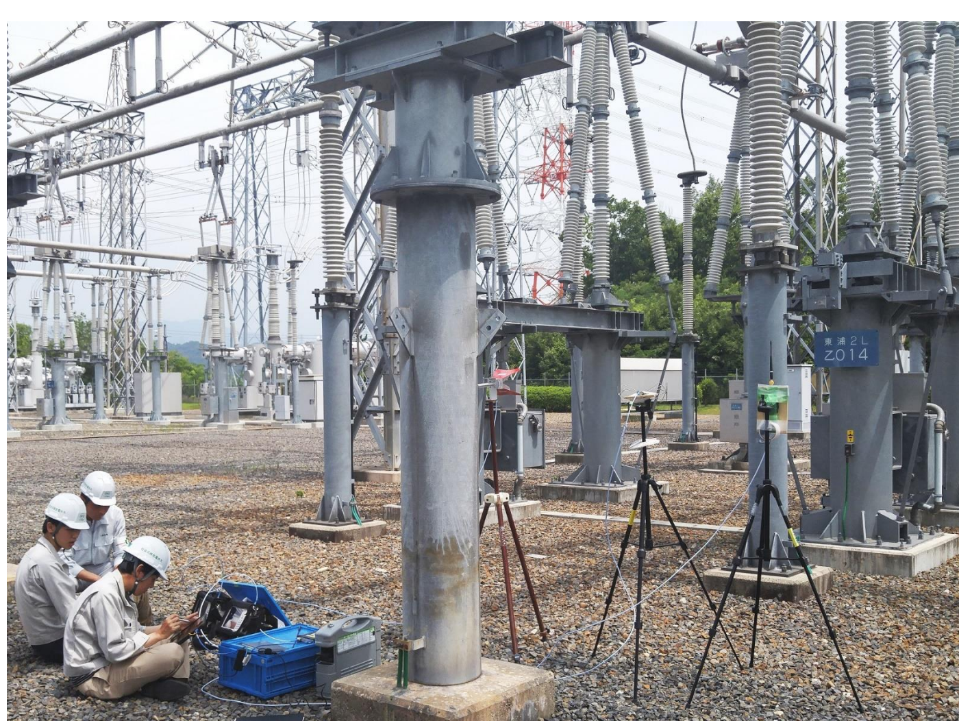
変電所 ノイズ環境調査・通信実験
