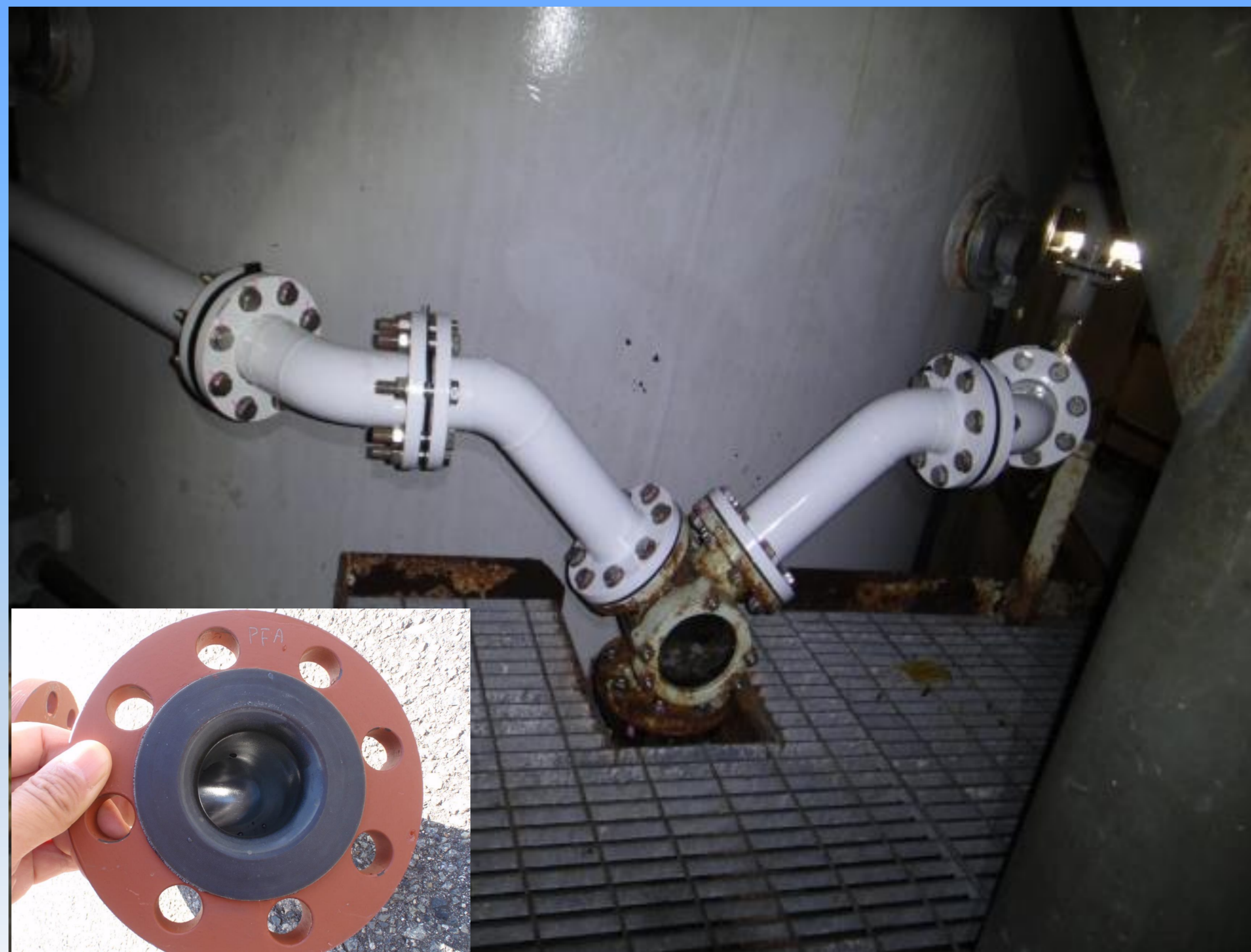
実機試験に設置したフッ素樹脂配管
