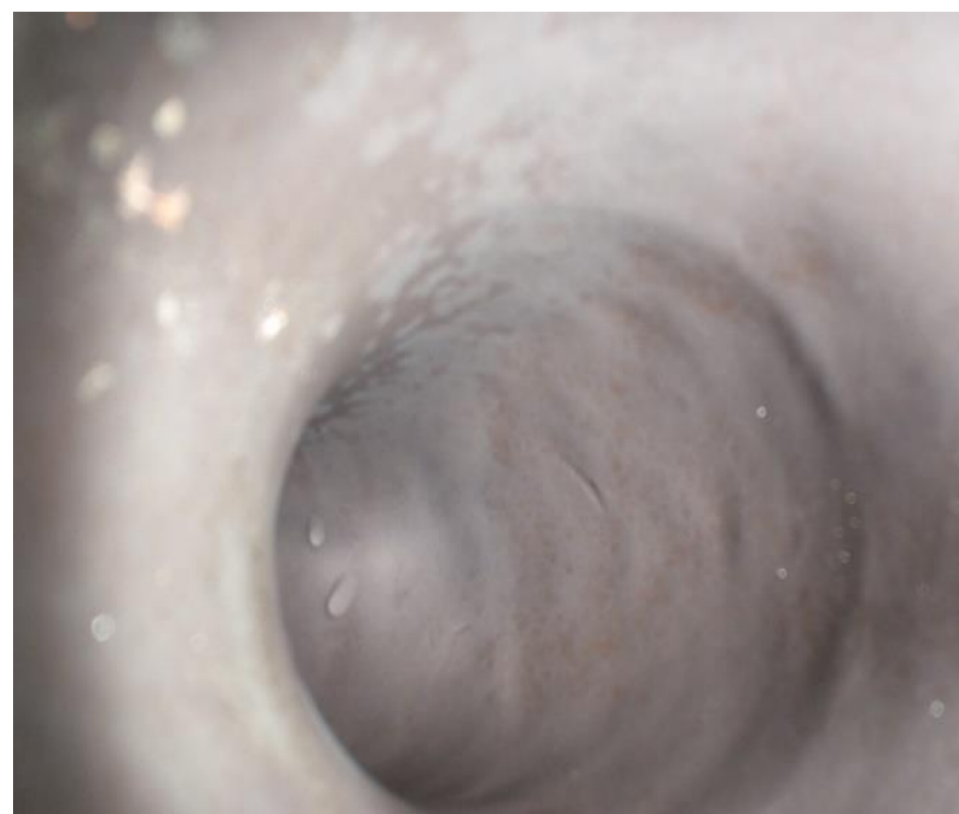
フッ素樹脂ライニング配管内の海生生物付着状況
