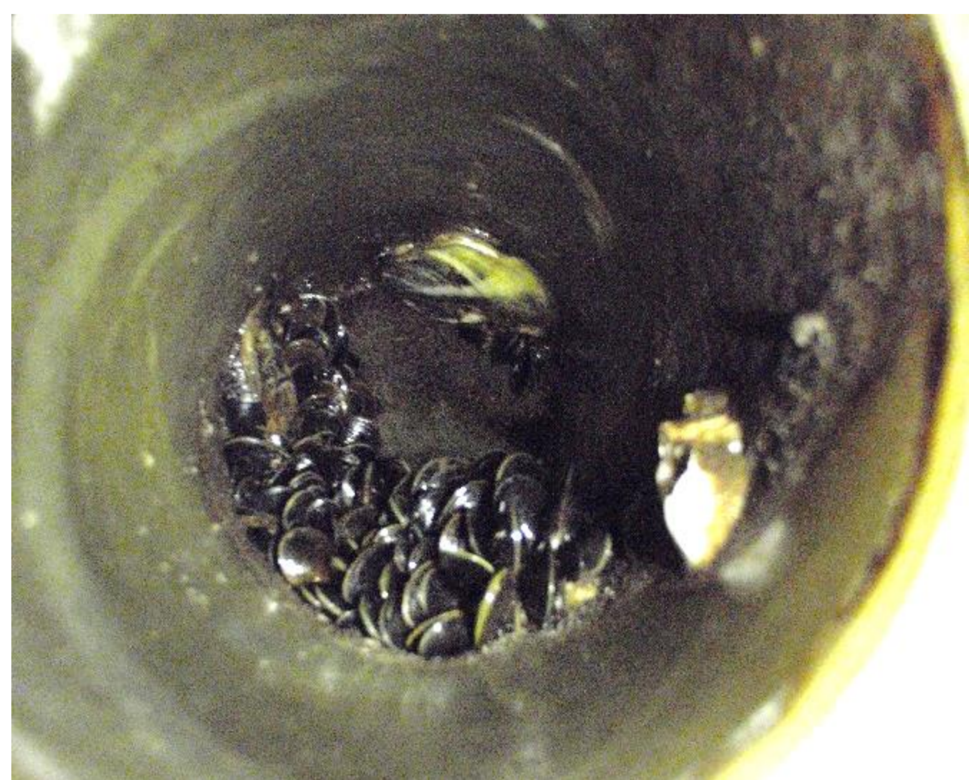
既設配管内の海生生物付着状況
