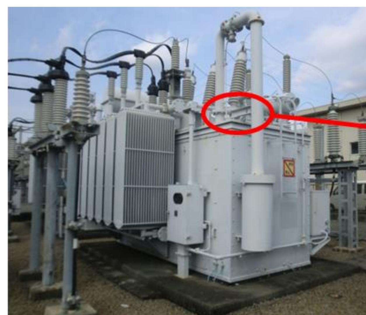
変圧器の外観
