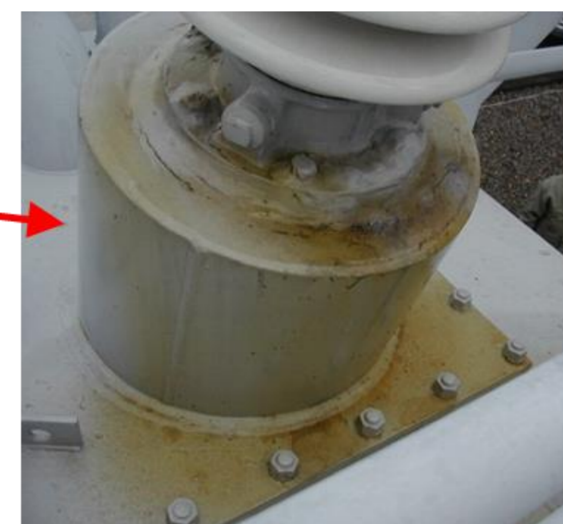
油密部からの漏油
