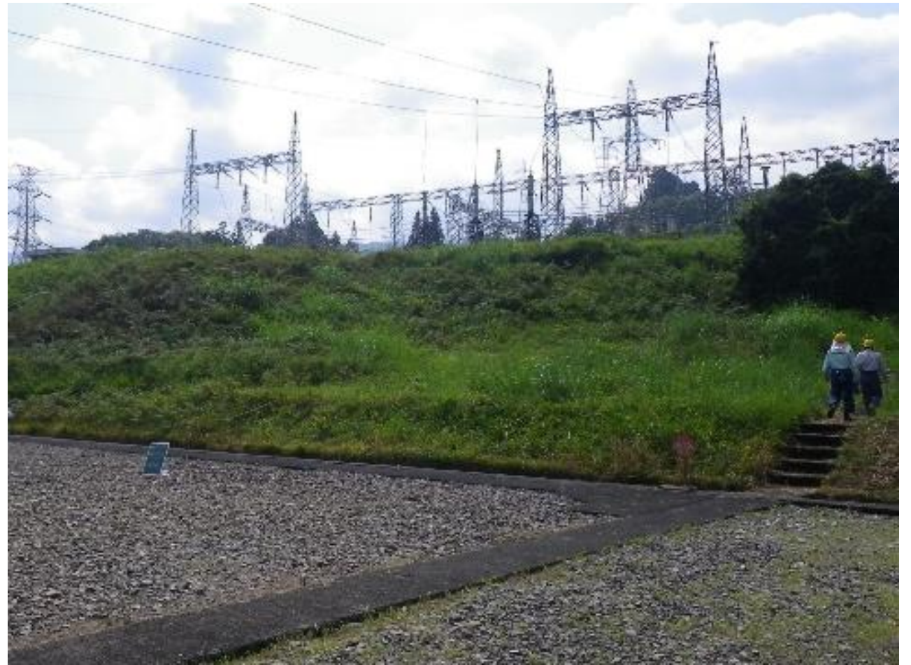
広大な変電所
