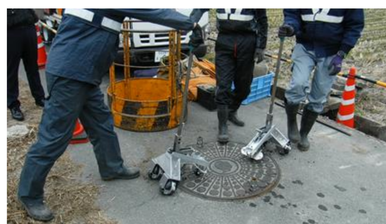
①マンホール「閉」
