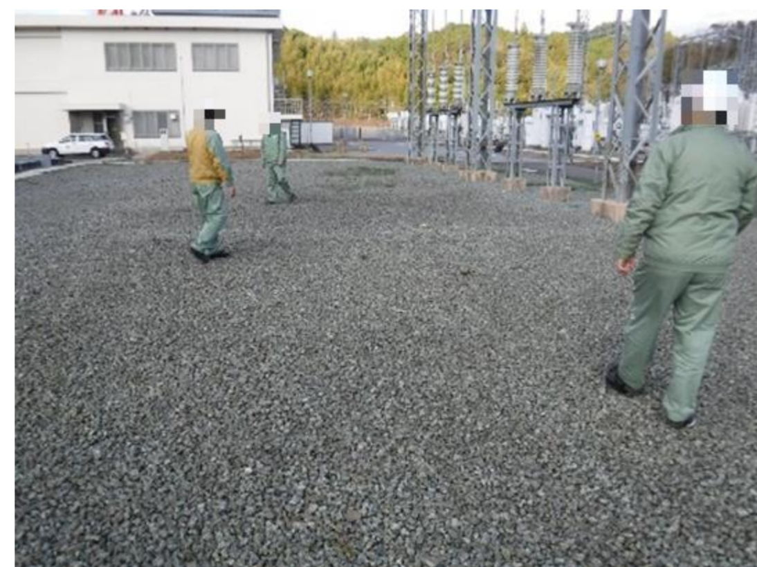
現場での検証(A変電所)
