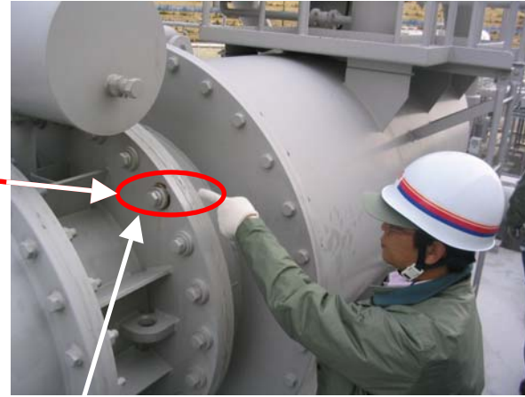
油がしみ出している箇所
