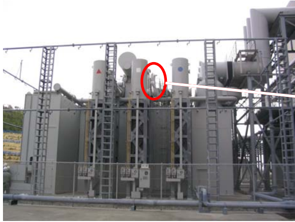
主要変圧器全体写真
